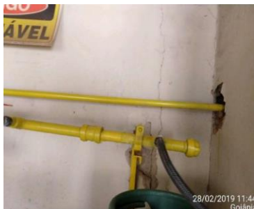
Figura 3. fissura vertical no sentido do chumbamento da tubulação
