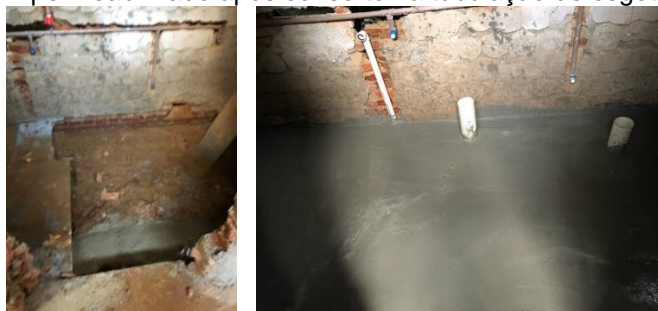
Figuras 27 e 28. banheiro sr Ozório piso recalcado 40cm e à direita contrapiso inteiro refeito e impermeabilizado após conserto na tubulação de esgoto
