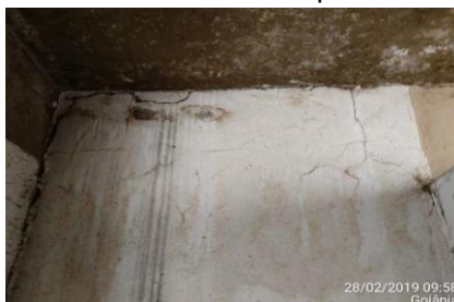
Figura 1. detalhe de fissuras mapeadas em parede.
