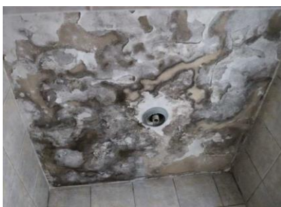
Figura 6. laje de concreto com bolor e mofo
